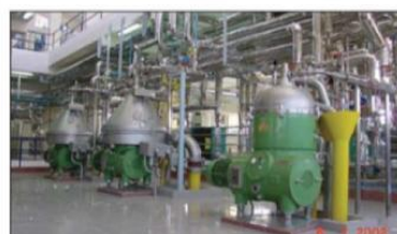
(i) شبکه لوله کشی در یک تاسیسات صنعتی.
